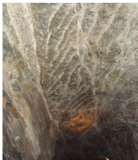
Abb. 8 Rillen durch Keilhaue verursacht
