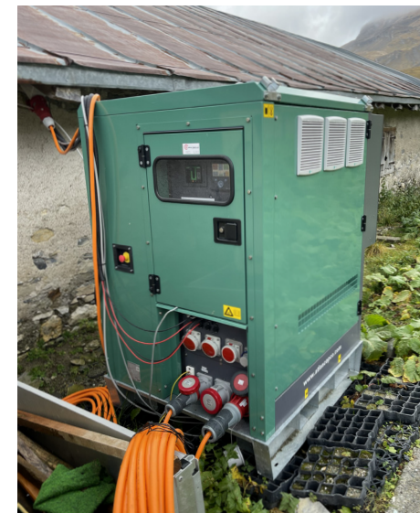
Dieser mobile Batteriespeicher speichert überschüssige Energie und gibt sie bei Bedarf ab. (Foto: Naturpark Beverin, Paul Däscher)
