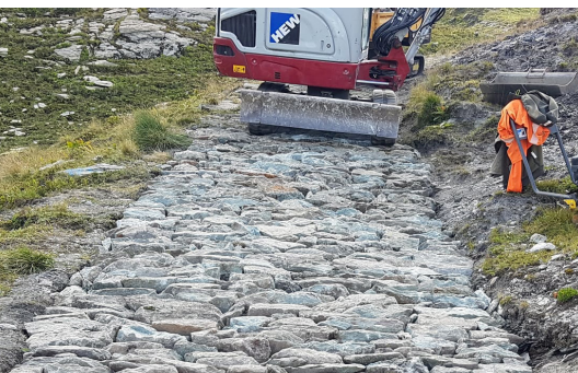
Die HEW AG setzte bei der Sanierung des historischen Kulturguts auf handwerkliche Präzision – so bleiben die von polnischen Kriegsgefangenen angelegten Pflasterungen als Zeitdokumente erhalten. (Foto: Naturpark Beverin, Reiner Schilling)
